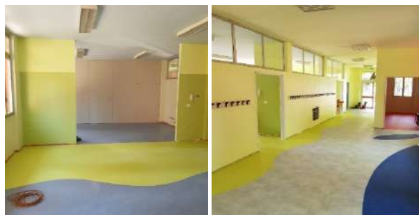
Scuola secondaria di I grado Leonardo da Vinci: completati i lavori di bonifica e riqualificazione (1 mln €)
